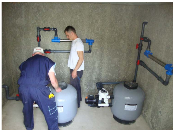
Sl. 9: Hidroizolaciona kućica za filtere i pumpe
